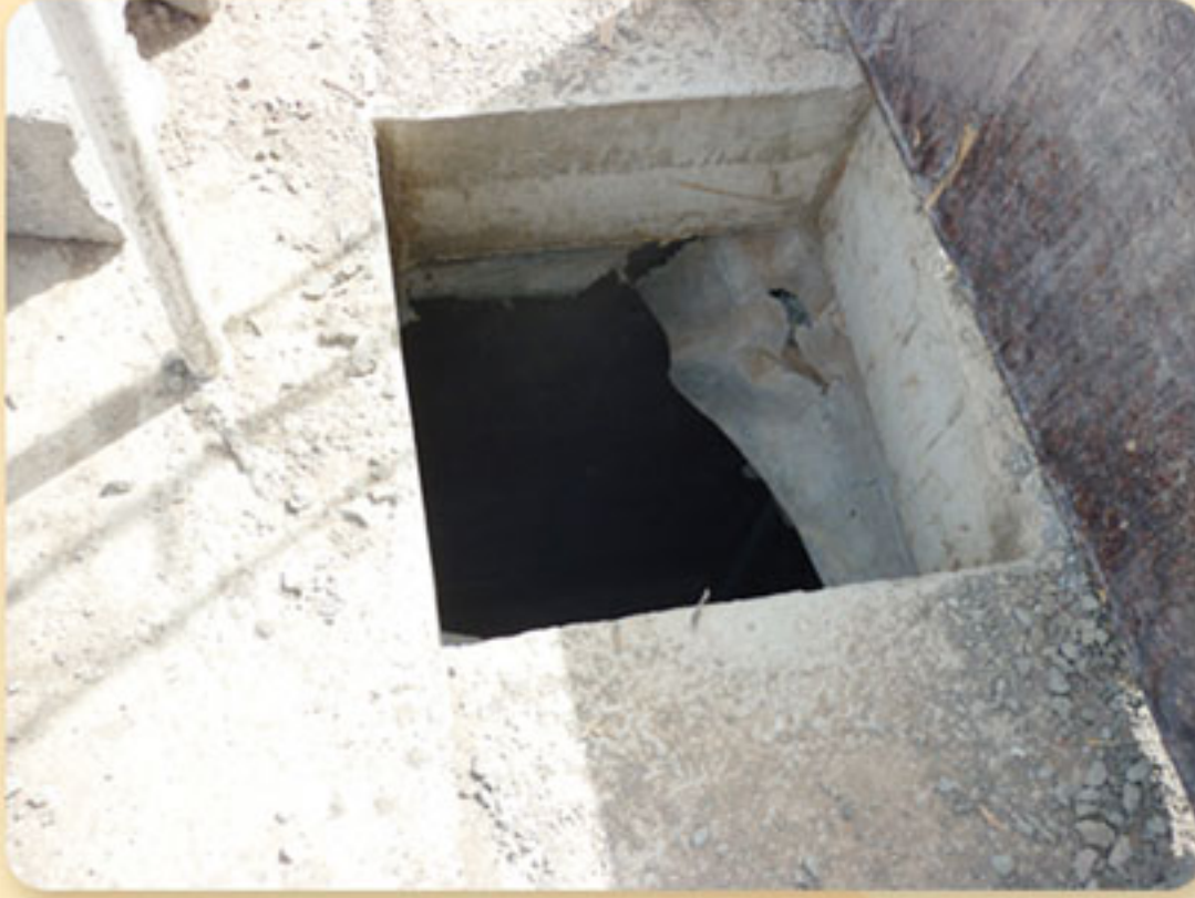
خزان أرضي مفتوح
